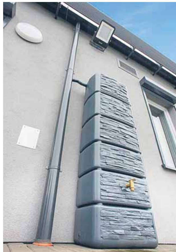
Zbiornik naziemny przy przedszkolu „Justynka” w Stawiszynie, zrealizowany w ramach zadania pn. Wykonanie systemu magazynowania wody opadowej przy Przedszkolu Samorządowym w Stawiszynie
