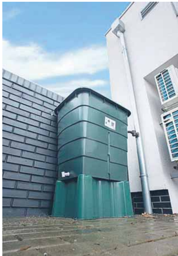
Zbiornik naziemny przy Budynku Tradycji w Godzieszach Wielkich, zrealizowany w ramach zadania pn. Wykorzystanie wody opadowej w celu nawadniania zieleni przy Budynku Tradycji w Godzieszach Wielkich.
